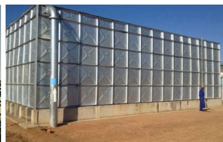
Tangki Penampungan Air
