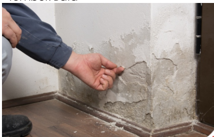
Dinding dengan Kelembaban Tinggi
